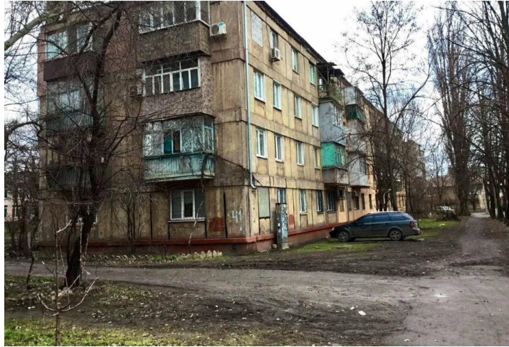
Рис. 1. Фізичний знос будівлі
