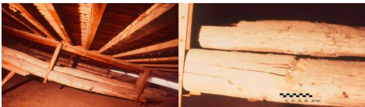
Рис. 4. Дефекти дерев'яних балок
